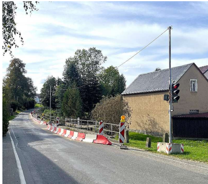
Straßeneinengung an der maroden Stützmauer
